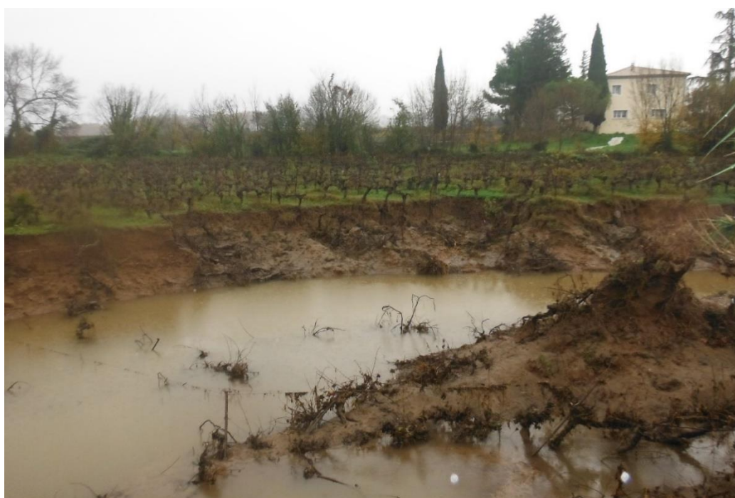
Brèche au bord de l'Hérault - crue de novembre 2014 – Tressan – photo EPTB FH
